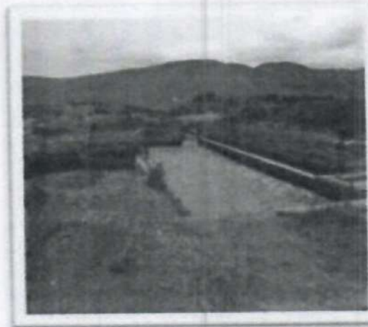
Desarenador y descarga de material de arrastre
