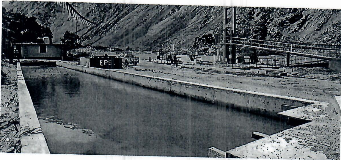
Unidad de pre-sedimentación en Bocatoma "El Canuto"
