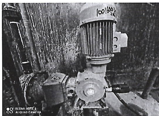
Ilustración 33 Bomba dosificadora de sulfato férrico
