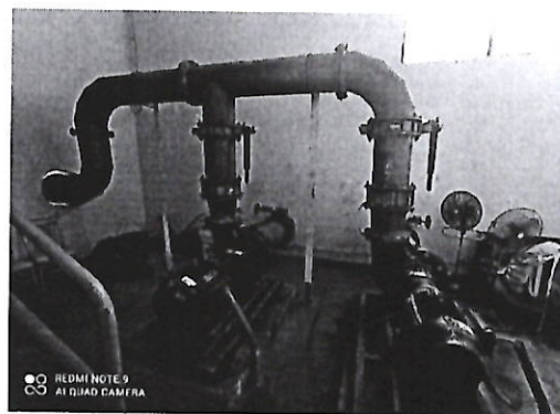
Ilustración 25 Bombas de lavado
