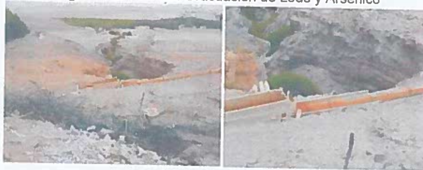
Figura 17: Tubería de agua proveniente de PTAP 02 Pampa Inalámbrica, expuesta a derrumbe
