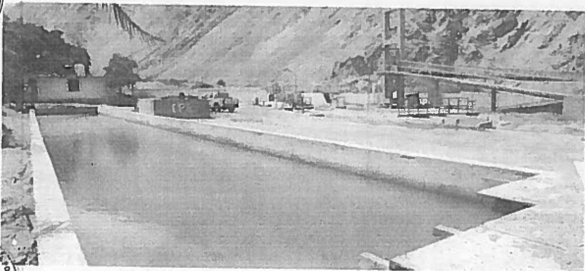
Unidad de pre-sedimentación en Bocatoma "El Canuto"
