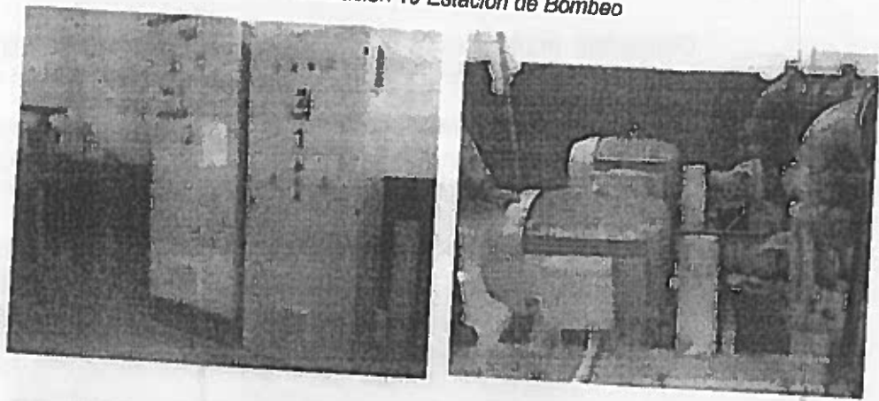
Ilustración 19 Estación de Bombeo
