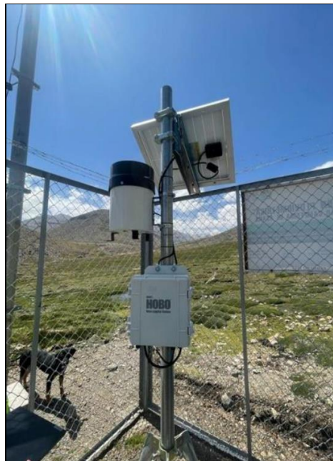
Figura N° 1: Vista de la estación pluviométrica instalada
