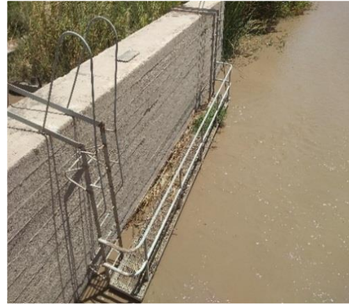
Ventana de Captación y Puente para Limpieza
