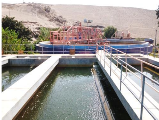
Instalaciones de PTAP Cata Catas
