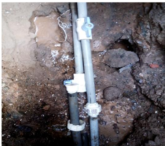
Fuga de conexión
