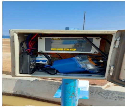
Equipos de medición de la PTAR
